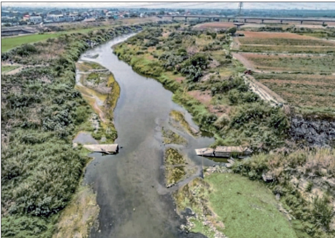
圖 1 舊有倒虹吸設施斷裂
