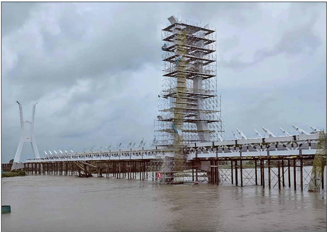
圖9 北港溪渡槽施工期間遭遇颱風來襲而引發溪水暴漲
