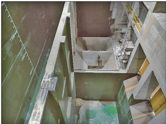
圖1 本中心雙貯坑設計之垃圾貯坑
