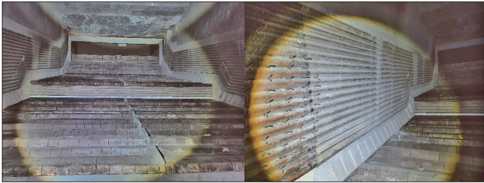
圖 2 水冷式爐床及水冷壁
