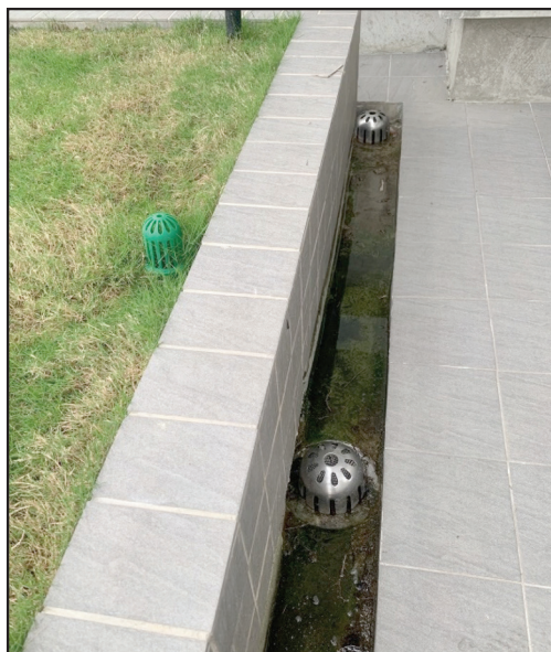
圖 4 屋頂雨水溝及落水頭雨水收集濾設備
