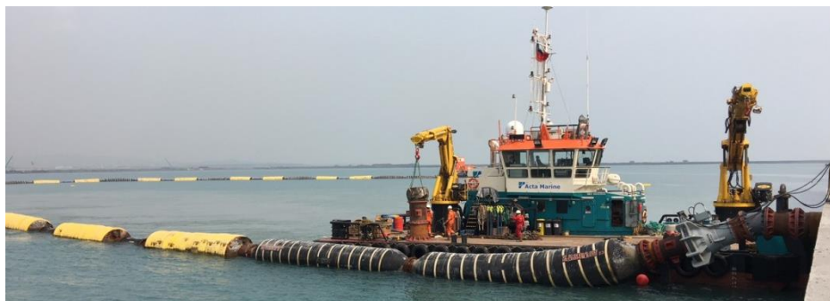
多用途功能工作船：Coastal Ace(荷蘭籍) 雙起重手臂工作船進行海上浮管設置
