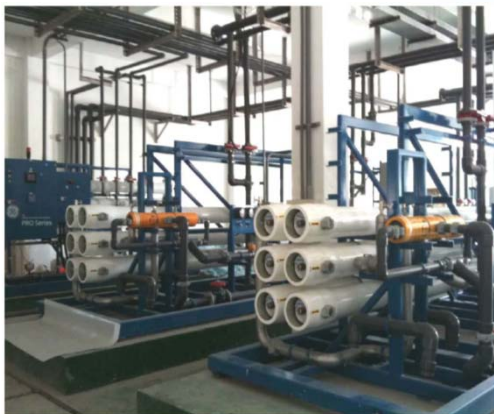
馬祖南竿950CMD海淡廠海水淡化機組
