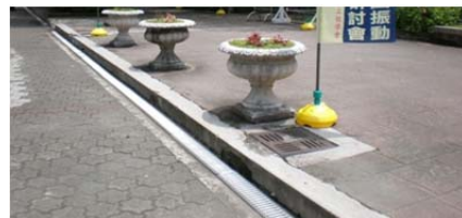
原有邊溝排水設施不具保水功能
