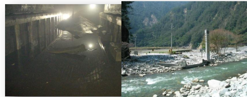
河床淤積至出風口，致使地下廠房及變壓器室等淹水
