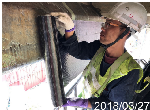
(E) 大梁 FRP 補強
