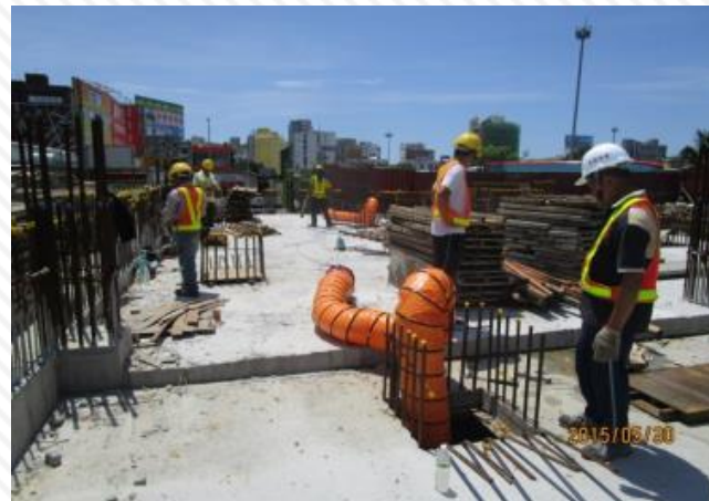
侷限空間使用通風換氣設備
