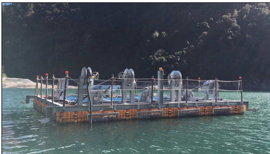
圖 23 壩前分層監測站之浮台
