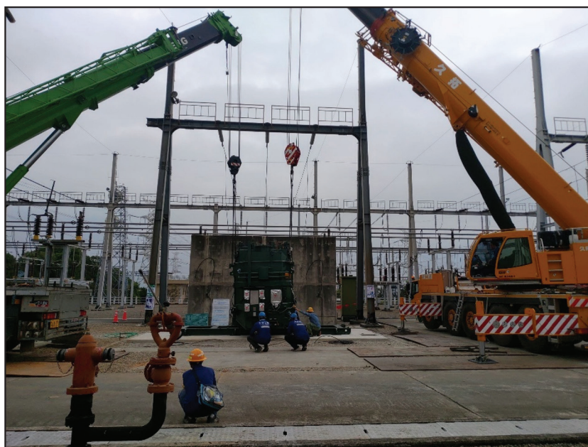
圖 54 變壓器現場裝機圖
