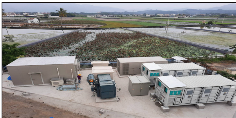
圖 46 高雄美濃區域電網儲能計畫案場照片
