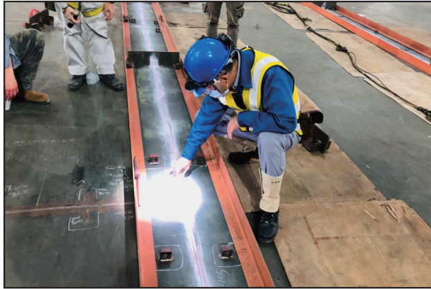
圖3 儲槽內槽底板銲道加強滲透液檢驗(PT)檢驗，品管人員拿放大鏡檢視顯像全白
