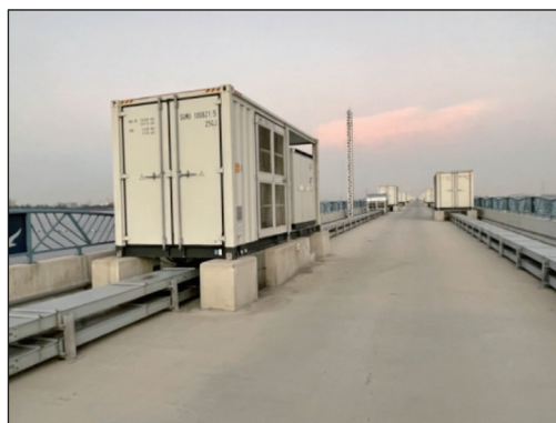
圖 6 變流器設於海上設備平台
