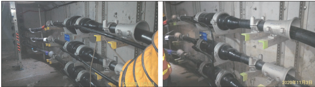
圖 12 161 kV 電纜設於地下洞道
