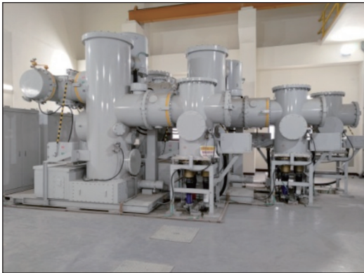
圖 7 SF 6 氣體絕緣開關 (GIS)
