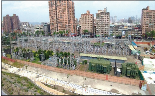
圖 16 舊屋外式板橋一次變電所
