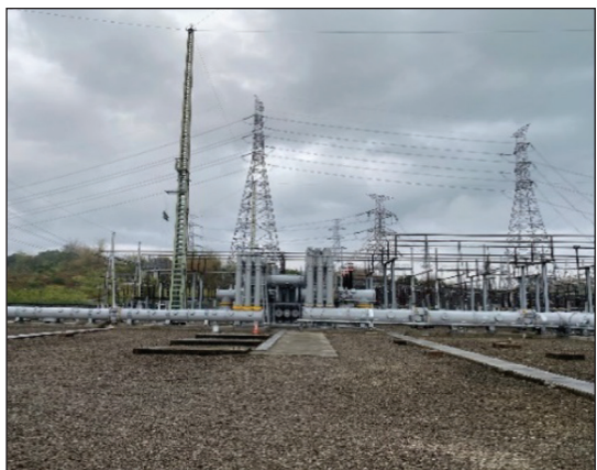
圖 53 龍崎 E/S 興達 ~ 龍崎一路及南科龍崎二路配合電源線容量提升工程 (2)
