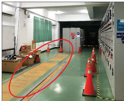
圖 32 大城 D/S 既設 CGIS 室備用空間
