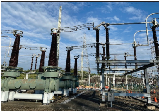
圖 52 龍崎 E/S 興達 ~ 龍崎一路及南科 ~ 龍崎二路配合電源線容量提升工程 (1)
