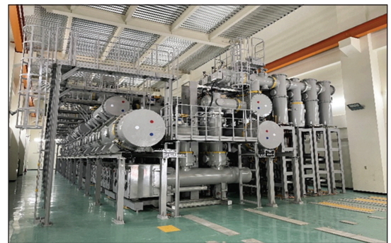
圖 13 345kV 氣體絕緣開關設備
