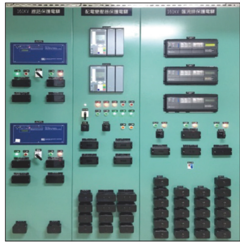
圖 23 電驛試驗訓練所初期保護電驛盤
