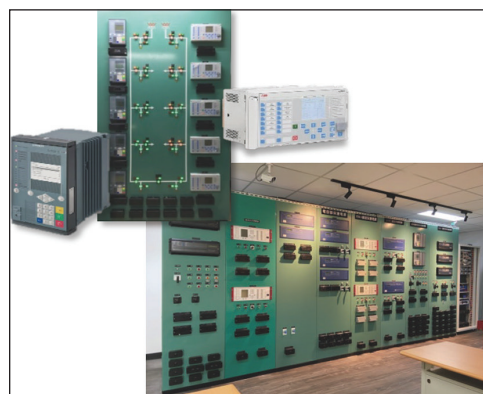
圖 28 智慧變電所運轉策略模擬中心內現有設備
