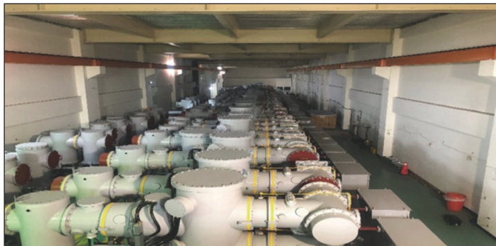
圖 6 161kV 氣體絕緣開關設備
