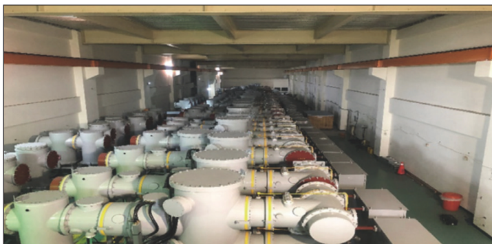
圖 6 161kV 氣體絕緣開關設備
