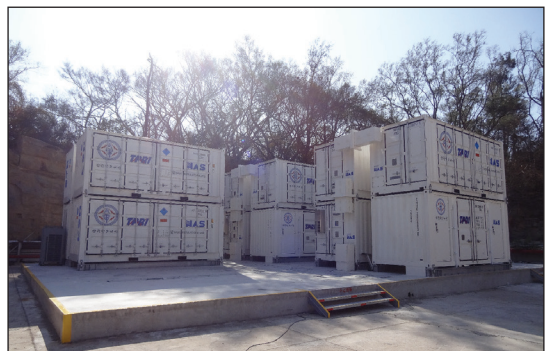
圖 15 鈉流電池儲能系統
