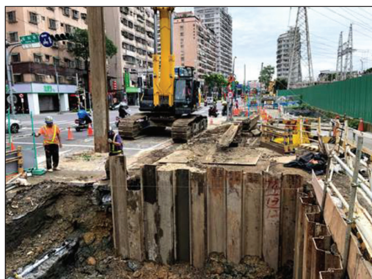
圖 22 板橋~景星紅白線 L 型涵洞
