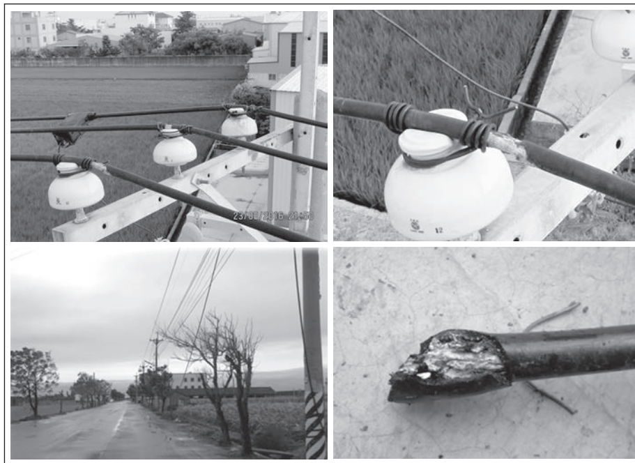
圖 7 被覆線老舊腐蝕情形
