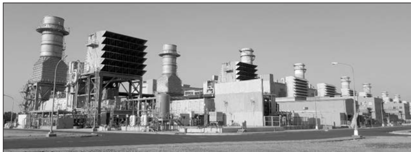
圖 4 大潭電廠 1~7 號機組
