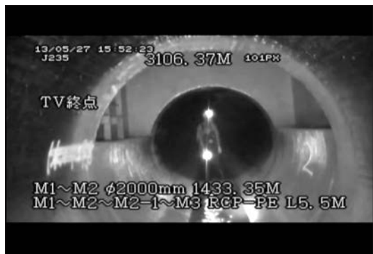
圖 8 中科放流專管 TV 檢視作業照片
