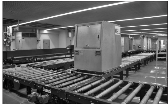
圖 2 行包處理系統 @A13 航廈站
