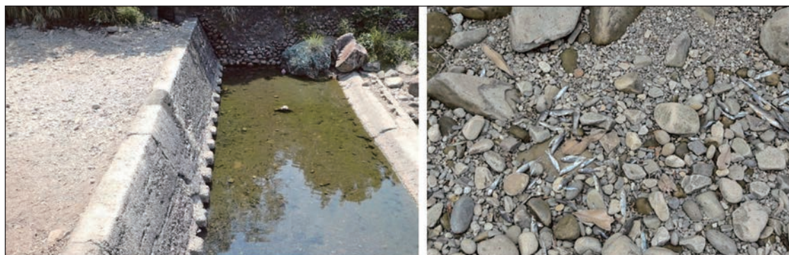
圖 7 改善前三堰旱季乾涸情形
