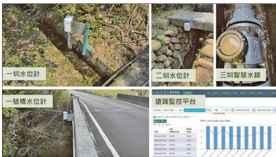
圖 27 田寮洋三條圳路開展智慧水管理
