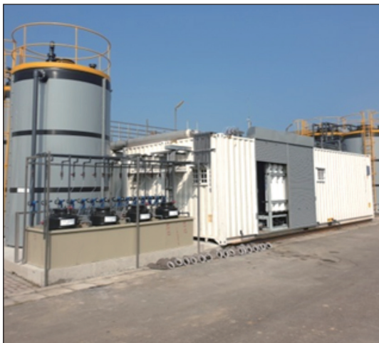
圖 13 RO 移動式淨水設備
