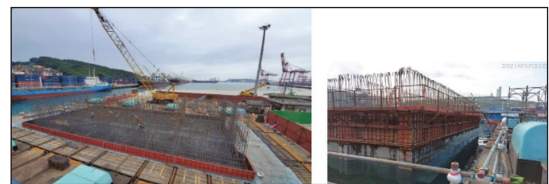
圖 9 基隆港 W28 碼頭之升降平台之施工安全防護設施照片
