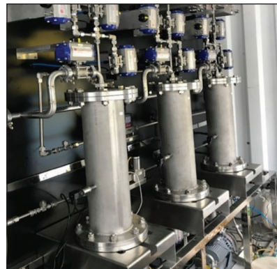
圖 6 三塔式真空變壓吸附裝置
