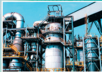
空氣污染防治系統 Air Pollution Control System
