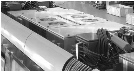
圖 4 國產化空調機
