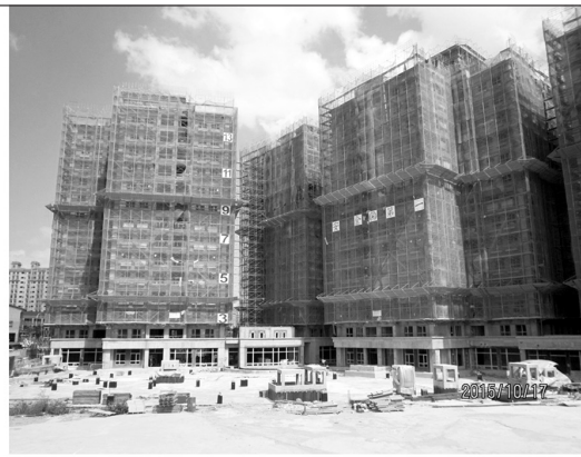
圖 8 工程停工時分項工程現場結算完成比例及工程整體外觀
