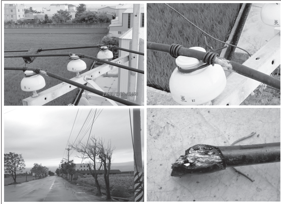
圖 7 被覆線老舊腐蝕情形
