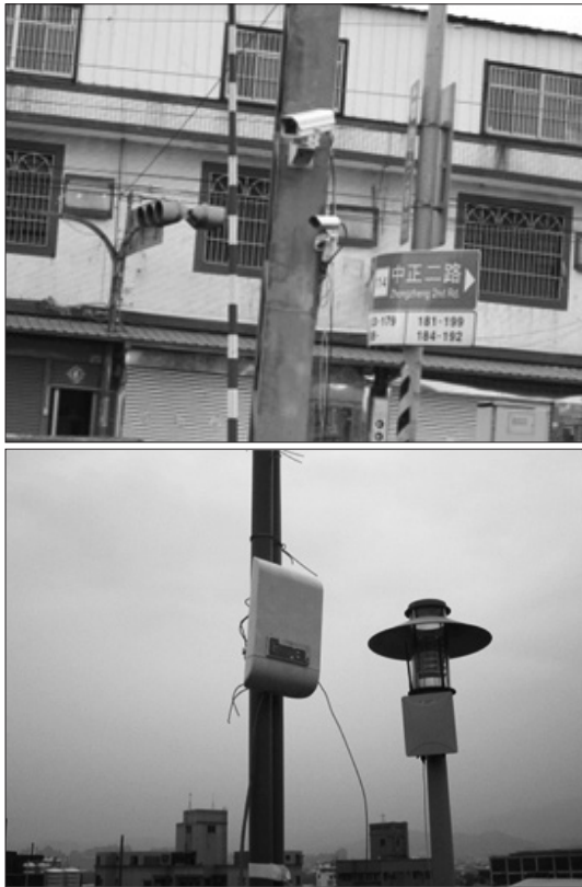
圖 8 影像傳輸設備佈建
